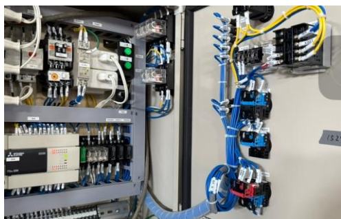
スマホでの開閉操作や地震・水害・火災を感じる生命維持装置の心臓部
